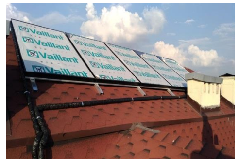
Paneles de calentamiento solar
