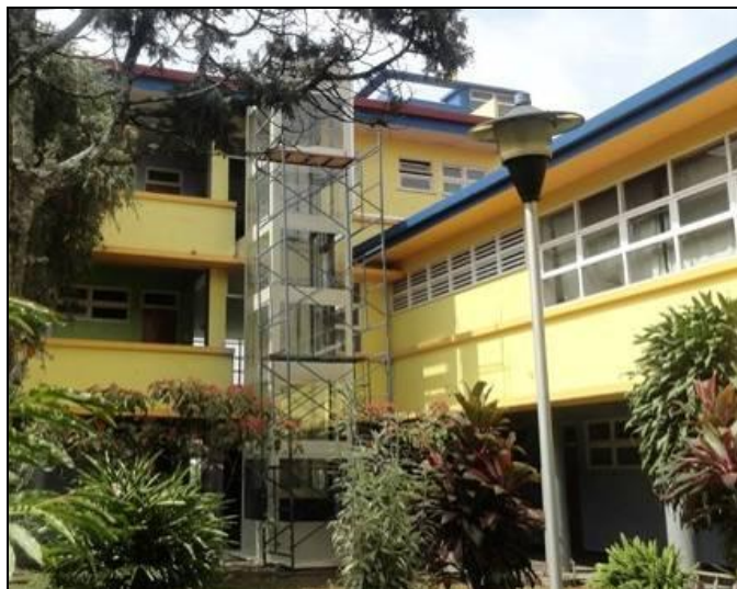
Le nouvel ascenseur au Collège
