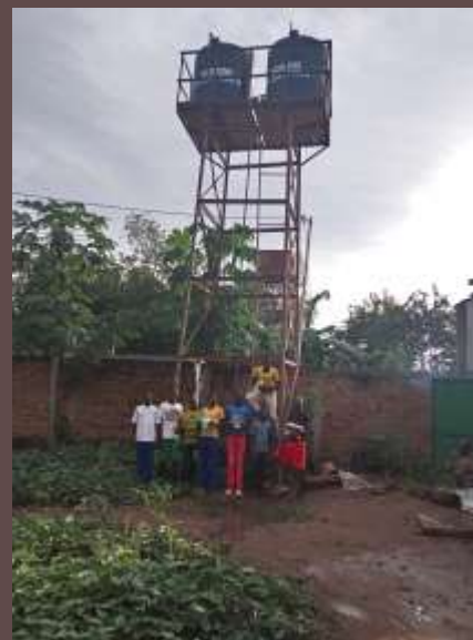
Tchad: Construction d'un forage et d'un réservoir aérien pour l'Académie Saint-Jean-Paul II, Petit Séminaire, Moundou.
