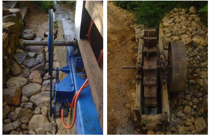
Antiguos y nuevos componentes del generador eléctrico
