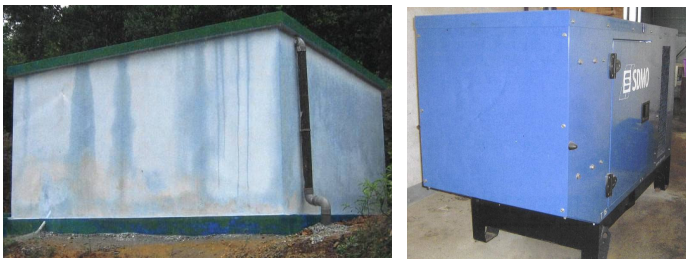
La nueva instalación del depósito de agua y el generador eléctrico en la Casa Provincial Marillac
