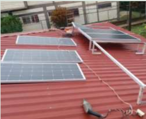
Honduras: Páneles Solares para la biblioteca y la oficina en Puerto Lempira.
