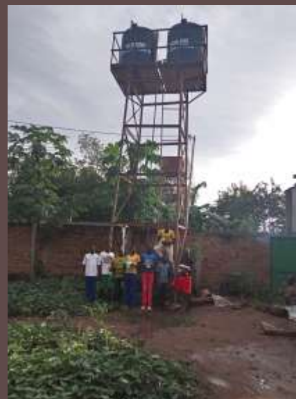
Chad: Construcción de un pozo e instalación de un tinaco para la Academia Saint Jean Paul II, Petit Seminaire, Moundou.
