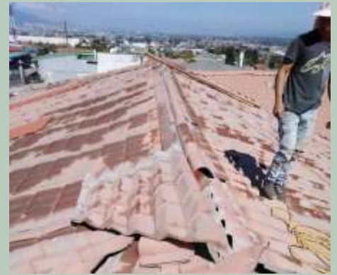
Costa Rica: Un techo nuevo para la casa de formación en el Seminario San Vicente de Paul.
