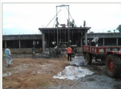
Construcción de la planta baja del colegio, 2017. El contratista Sr. G. Narayana Rao supervisa el trabajo.
