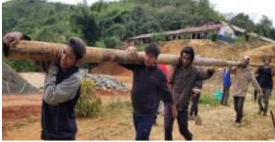
Construcción del salón comunitario de la parroquia De Paul en Manipur India
