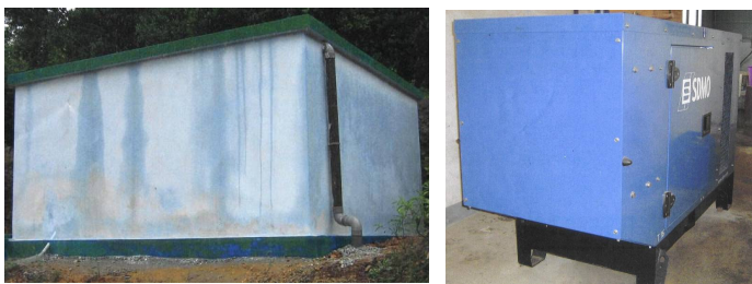
Le nouveau réservoir d'eau et le générateur électrique à la Maison Provinciale de Marillac
